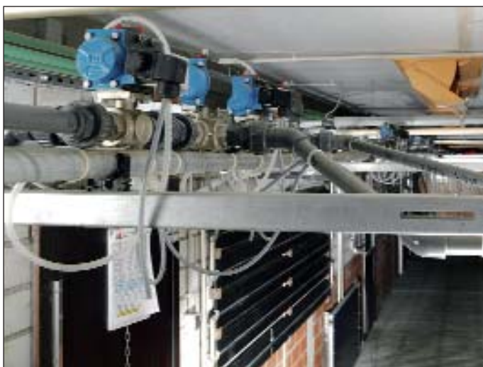
Installation der Futterventile im Zentralgang
